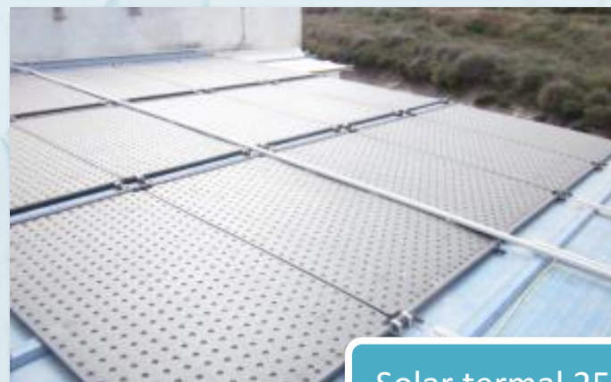
Solar thermal 25kW
