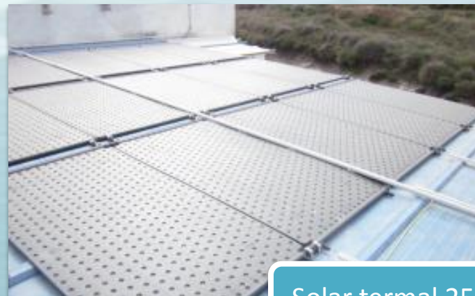
Solar thermal 25kW
