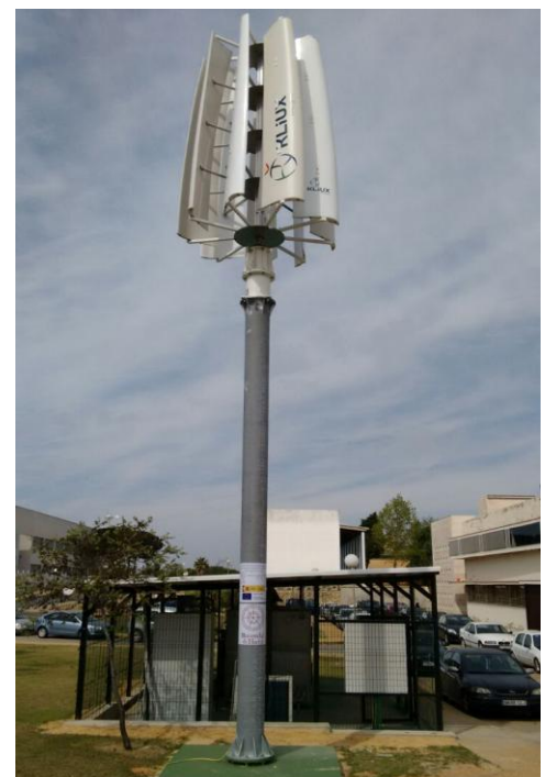
Aerogenerador y sistemas de producción de hidrógeno en la UHU
