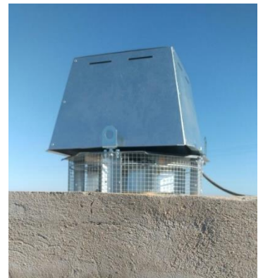
Extractor cenital para gases explosivos instalado en Esteros de Canela
