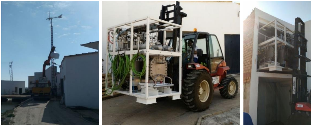
Instalación del prototipo de electrolisis y el tanque a presión en Esteros de Canela
