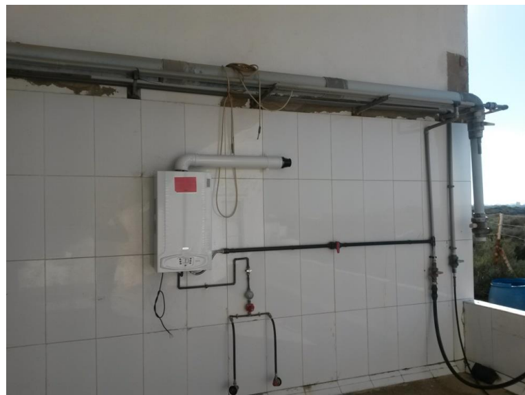
Ilustración 5. Detalle de la caldera
